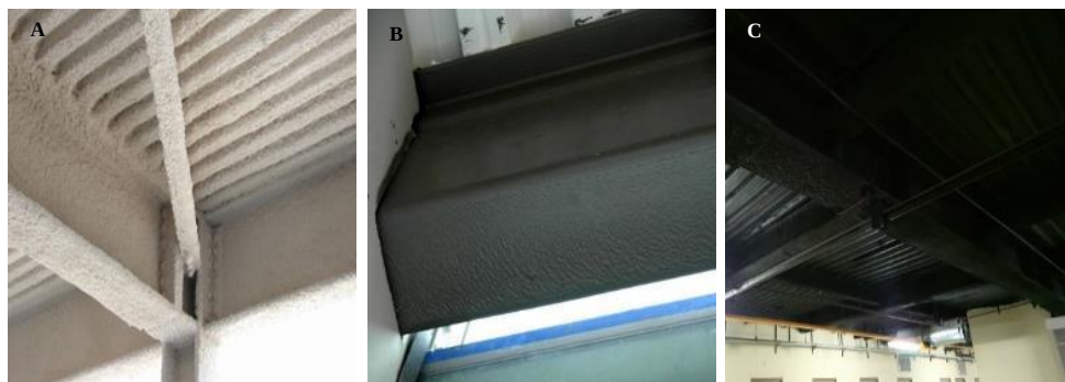
شکل ۷-۱۷ نمونه‌هایی از پوشش‌های ضدحریق: (A) پوشش ضدحریق معدنی بر پایه گچ، (B) پوشش رنگ‌های منبسط شونده، و (C) پوشش رنگ‌های منبسط شونده بر پایه سیمان، اجراشده در برج کوهسنگی مشهد (تصویر: شرکت مهندسی ایزاردقیق گستر بارثاوا).
